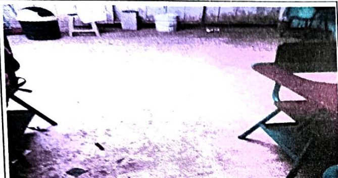
Foto 1: EN EL MODULO 1 SE OBSERVA EL PISO EN MAL ESTADO
