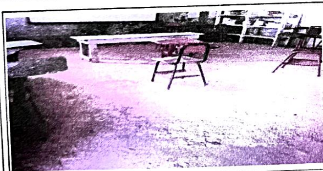
Foto 5: EL PISO MODULO 3 ESTAN EN MAL ESTADO
