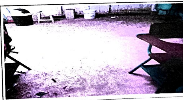
Foto 6: EL PISO SE ENCUENTRAN EN MAL ESTADO
